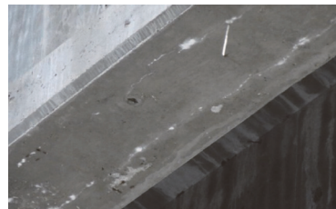
写真-3 下フランジ下面のひび割れ
