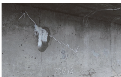
写真-1 ウェブ側面のひび割れ
