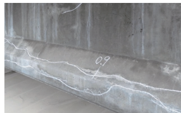
写真-2 下フランジ側面のひび割れ
