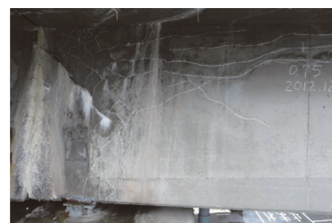
写真-4 支点周辺のひび割れ
