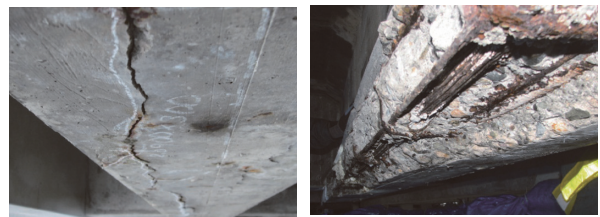
写真 - 1 PC 桁の損傷状況
