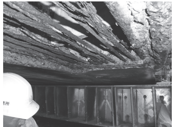
写真 - 3 桁下面の損傷状況 ①
