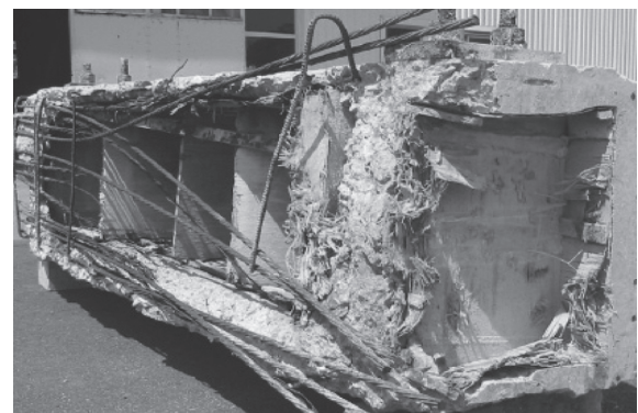
写真 - 4 桁下面の損傷状況 ②
