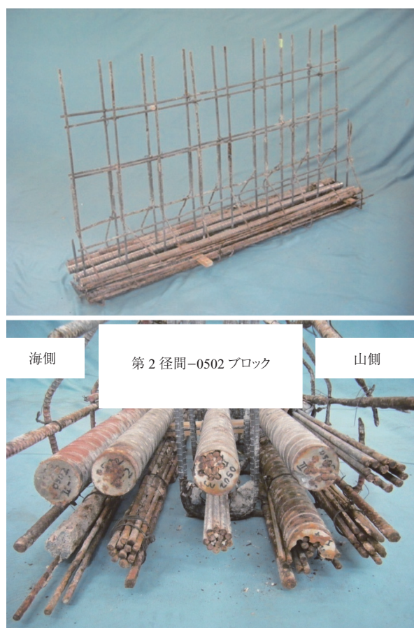
写真 - 2 桁内の鋼材腐食状況
