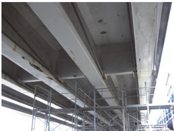
写真 - 1 本橋の劣化状況
