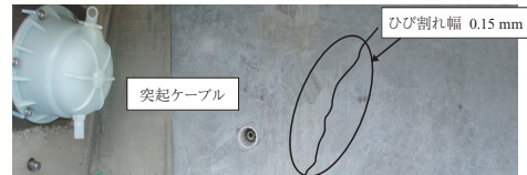
写真 - 1 タイプ② ひび割れの発生状況
