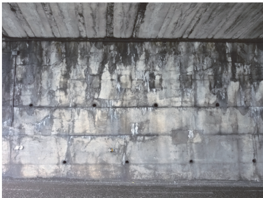
写真 - 3 橋台のひび割れ
