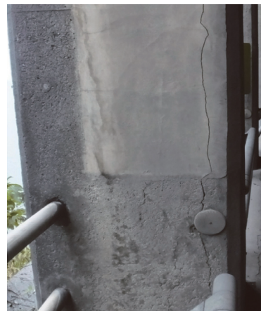
写真 - 2 橋脚のひび割れ
