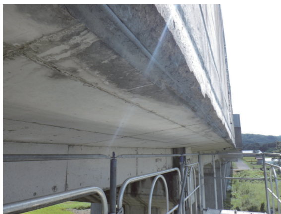
写真 - 1 水切り部の劣化事例
