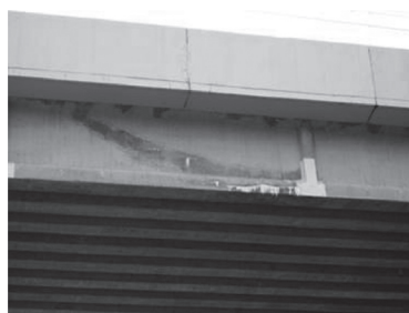
写真 - 2 主ケーブルに沿うひび割れ
