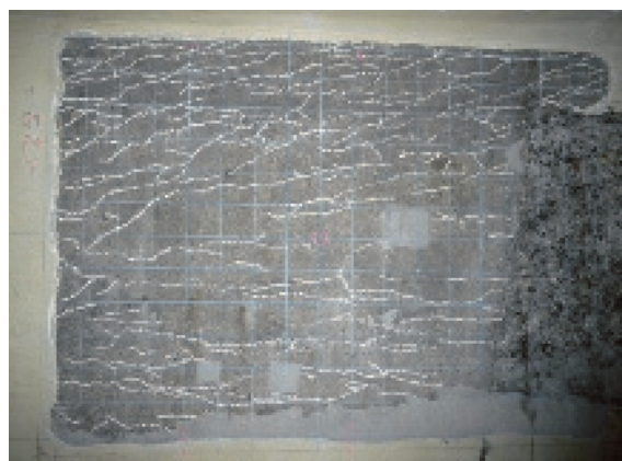
写真 - 1 主桁ひび割れ状況
