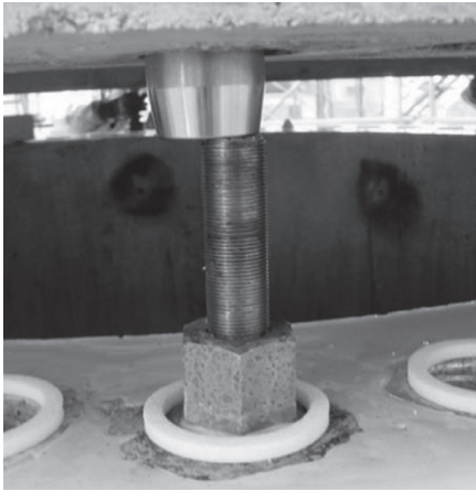
写真 - 13 PC 鋼棒接続不良の例
