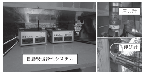
写真 - 10 自動緊張管理システム
