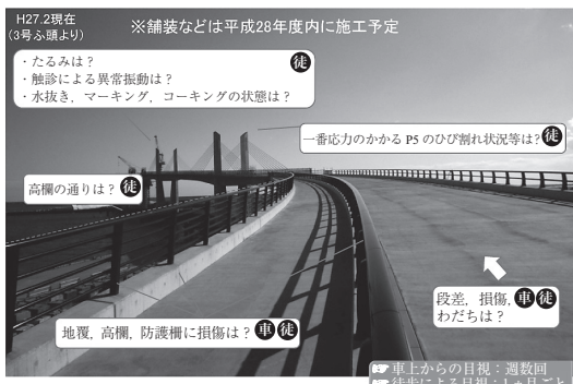
写真-8 橋面からの変状確認（チェックポイント1）
