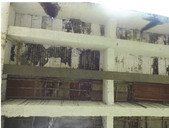
写真 - 7 内在塩分により腐食した桁と床版 (ミャンマー)
