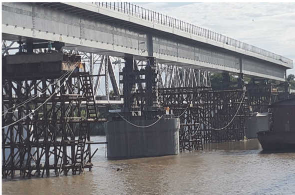
写真 - 10 Myintge 橋梁架設の状況 (2016年8月開業, ミャンマー国鉄提供)
