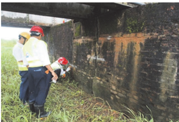
写真 - 11 橋梁下部工に発生したひび割れの監視状況
