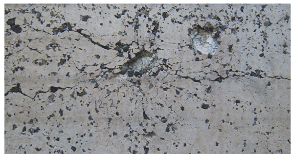
写真 - 1 凍結融解試験でみられるひび割れ
