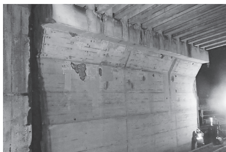
写真 - 2 橋台コンクリート表面のはく離
