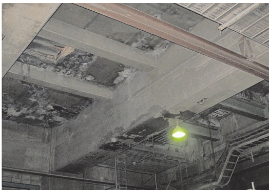
写真 - 1 劣化したRC床版
