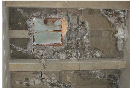
写真 - 2 鉄筋露出状況
