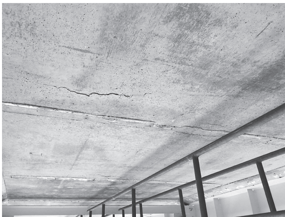
写真-1 支点部付近の浮き
