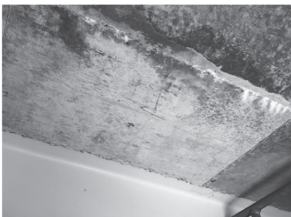
写真-2 ハンチ部の漏水・エフロレッセンス
