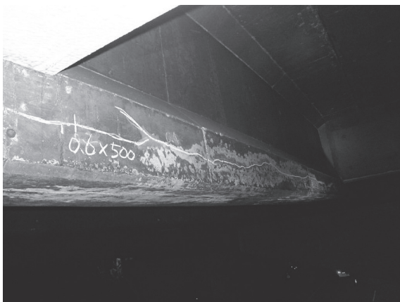
写真 - 4 PC 桁の損傷状況
