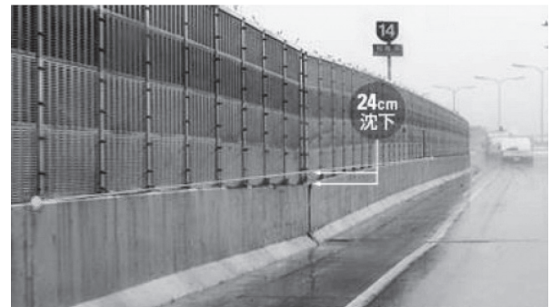
写真-2 壁高欄の沈下状況（2003年）
