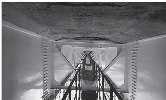
写真 - 1 床版下面状況
