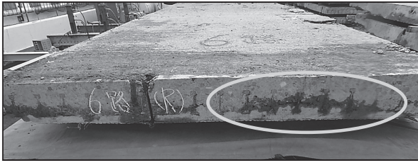
写真 - 1 撤去床版の断面
