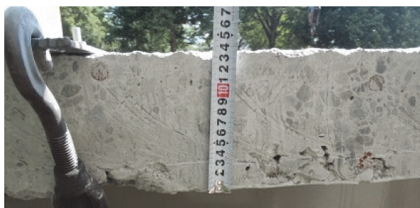
写真 - 1 度重なる切削により薄くなった床版
