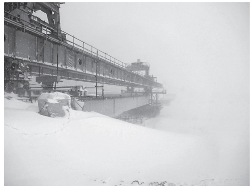
写真 - 13 暴風雪時の現場状況
