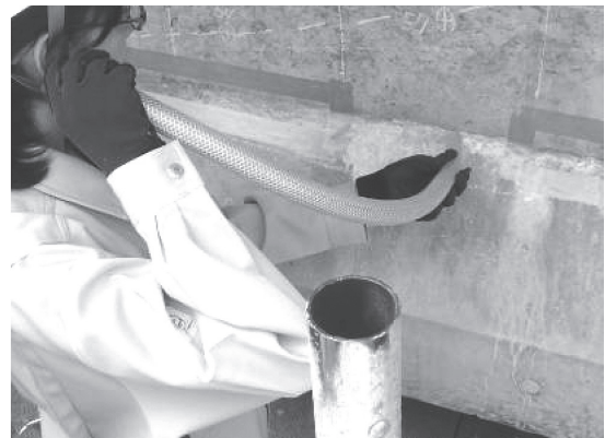
写真 - 2 ひび割れから生じた漏気音の確認状況 (No.3 ケーブル起点側)
