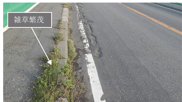
写真 - 5 路肩部の雑草繁茂
