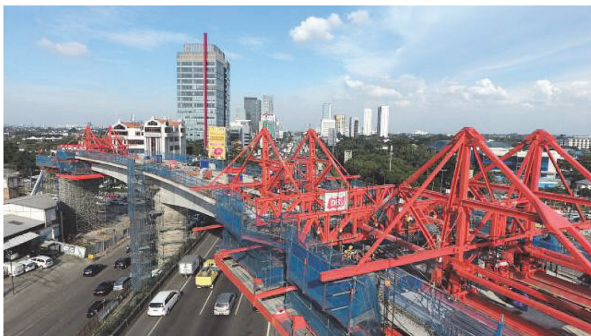
写真 - 6 移動作業車を用いた張出し架設工法による架設状況
