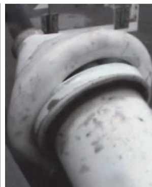
写真-3 ゴムカバーの亀裂
