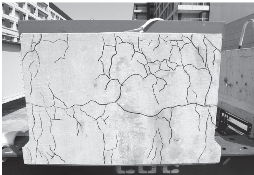
写真 - 5 桁端部における亀甲状のひび割れ (H 試験体)
