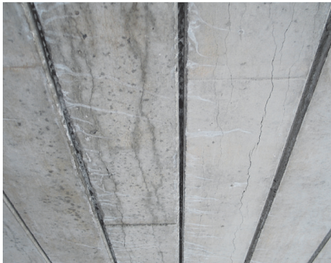
写真 - 2 PC ホロー桁で発生した ASR によるひび割れ
