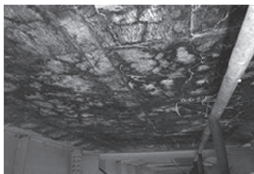
写真 - 1 RC 床版下面の劣化状況
