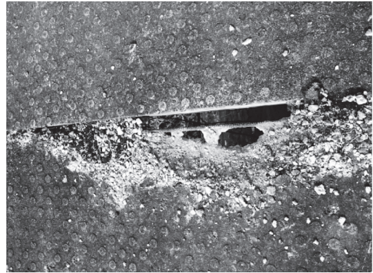
写真 - 2 プレキャスト RC 部材の凍害例 2
