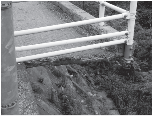
写真 - 1 プレキャスト RC 部材の凍害例 1
