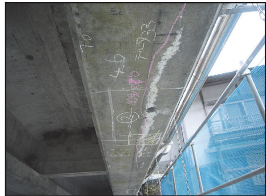
写真 - 2 下フランジ下面の損傷
