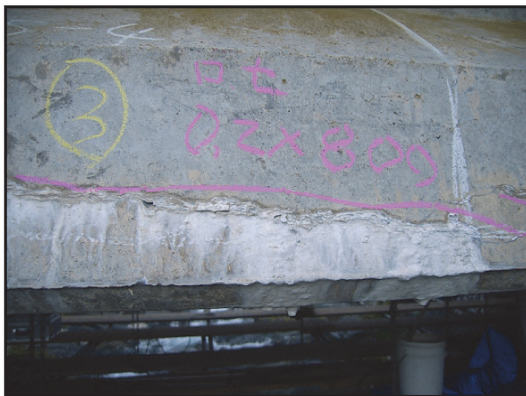
写真 - 1 下フランジ側面の損傷
