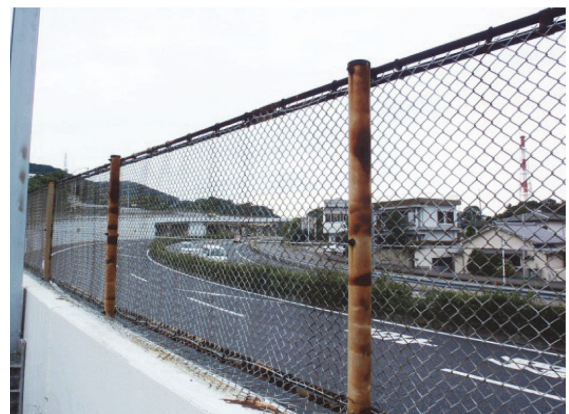
写真 - 22 落下物防止柵の腐食事例
