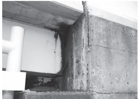
写真 - 12 桁端部の劣化事例
