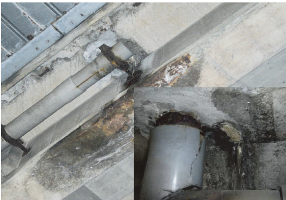
写真 - 18 床版の劣化事例
