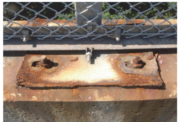
写真 - 21 鋼製アンカーボルトの腐食事例
