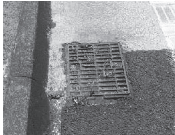
写真 - 24 土砂の堆積による排水阻害事例
