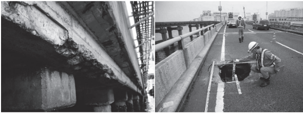
写真 - 1 1号羽田線損傷状況 (首都高提供)
