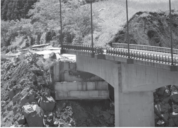
写真 - 1 A1 橋台の沈下状況（阿蘇長陽大橋）
