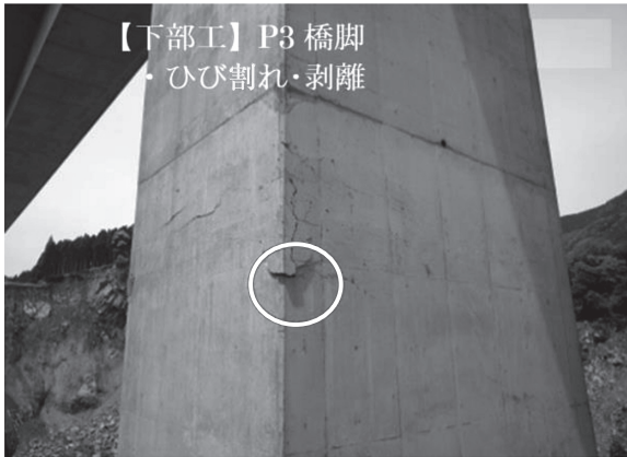
写真 - 2 P3 橋脚の損傷状況（阿蘇長陽大橋）
