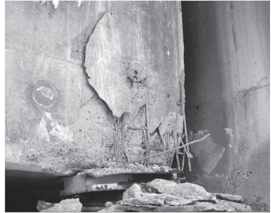
写真 - 3 主桁端部の損傷状況（阿蘇長陽大橋）
