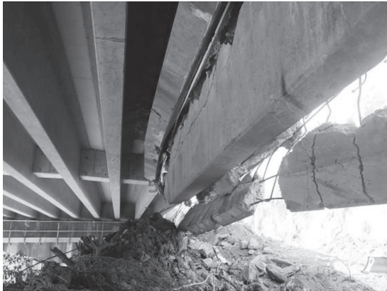
写真 - 5 P3～P4 径間の被災状況 (戸下大橋)
