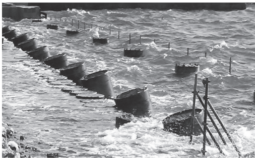
写真 - 6 杭頭部水没状況
