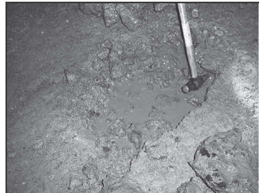
写真 - 9 既設床版の土砂化 (上面増厚の撤去後)
