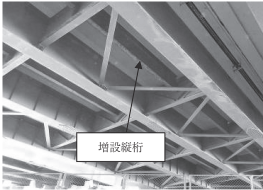
写真 - 4 縦桁補強事例
