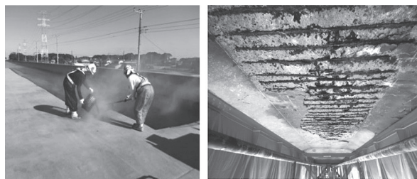
写真 - 2 床版防水層施工状況 写真 - 3 床版下面かぶり剥落状況
