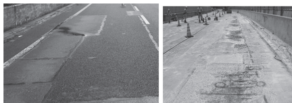
(a) 舗装面 (b) 床版上面 写真 - 1 床版上面の変状事例
