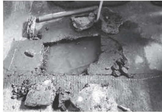
写真 - 7 上面増厚変状 (既設床版との剥離)
