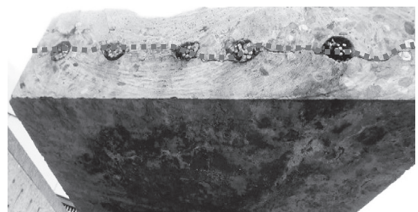
図 - 2 床版に発生した水平ひび割れ
