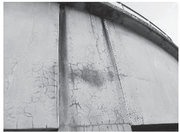
写真 - 2 亀甲状のひび割れ
