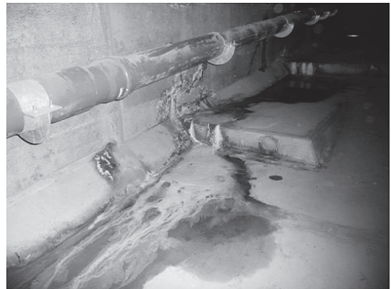
写真-1 定着突起からの漏水
