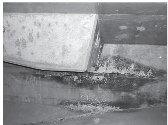
写真-2 ウェブからの漏水
