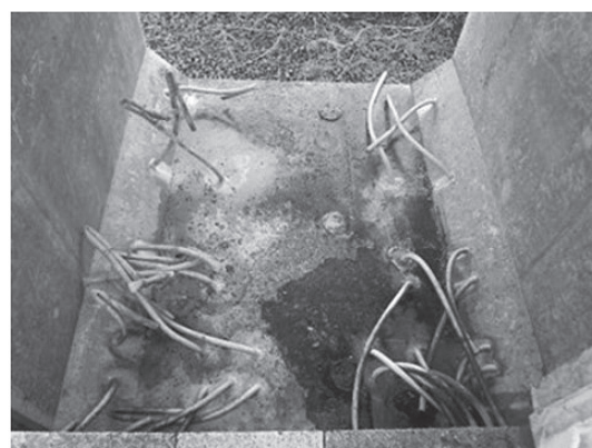
(b) 補修なし (漏水あり)
