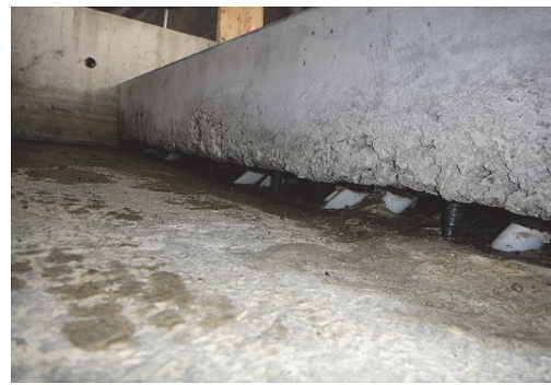
写真 - 13 敷砂除去後の模擬地覆下の空洞
