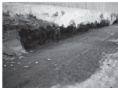
写真 - 11 ドライモルタル除去後の地覆下の空洞
