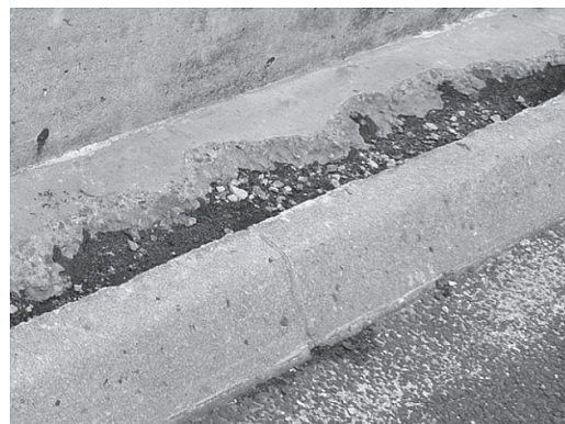
写真 - 6 漏水を生じた橋の橋面の状況の例
