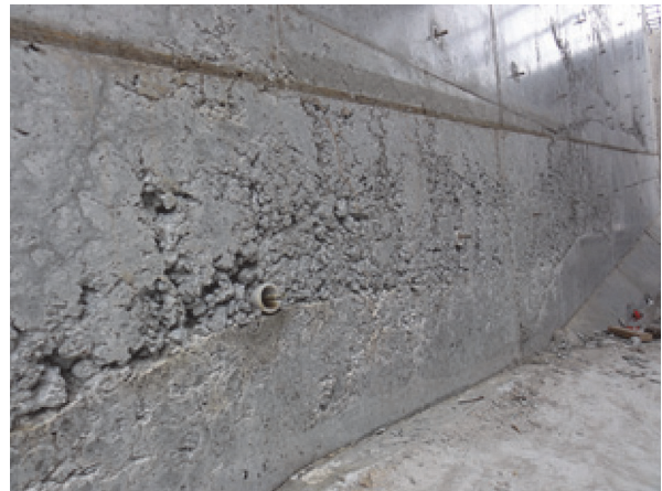
写真 - 1 発生した豆板の状況
