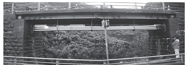
(a) 側面の劣化状況 (海側から観察)
