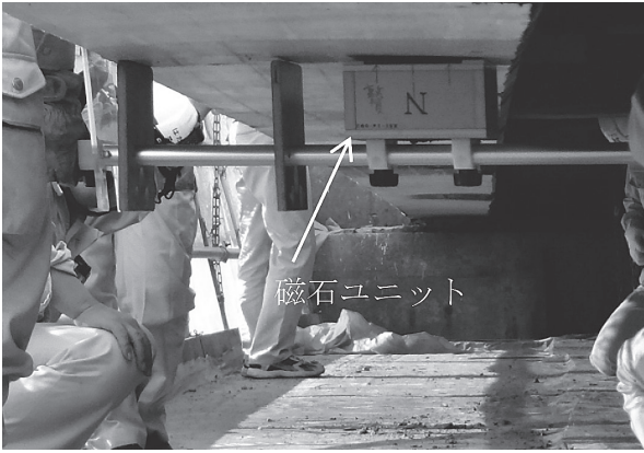
写真 - 5 PCT 桁橋桁中央下フランジ部下面側の着磁状況
