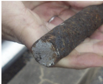
写真 - 2 横締め PC 鋼棒の破断事例 (筆者撮影)
