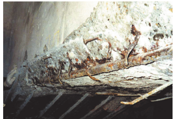
写真 - 1 栈橋上部工下面の劣化状況
