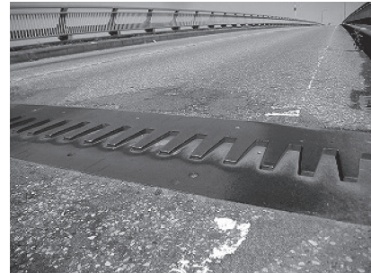
写真 - 4 伸縮装置の段差
