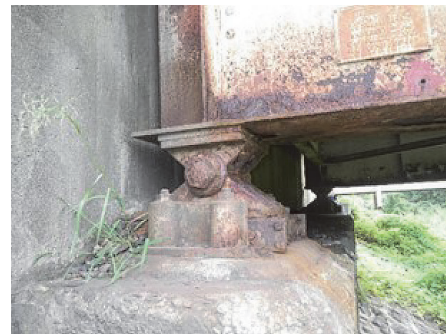
写真-1 漏水による支承・主桁の腐食
