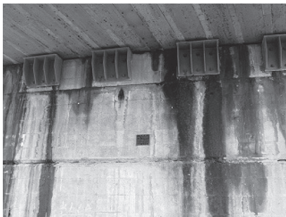
写真 - 2 下部工の漏水跡
