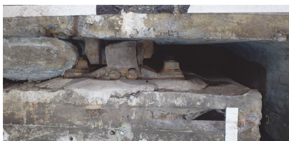
写真 - 1 ゲルバー部支承損傷状況
