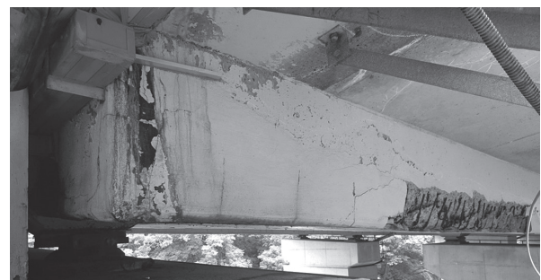
写真 - 6 RC 中空床版橋の劣化状況
