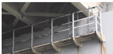
写真-4 腐食した検査路事例
