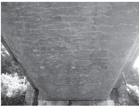
写真 - 1 中空床版下面のひび割れ状況
