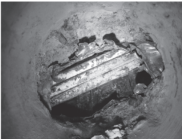
写真 - 1 グラウト未充填状況
