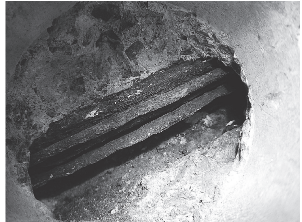
写真 - 2 とくに著しい PC 鋼材腐食状況
