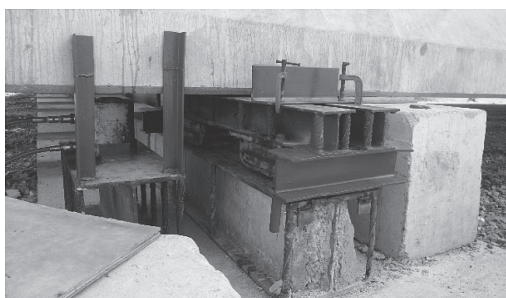
写真 - 4 写真 - 3 の改善例（鋼材でうける）
